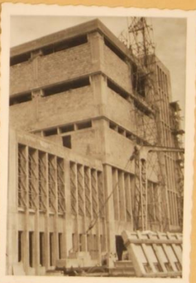
FILTRATION SALLE DE BROSSAGE SILOS
